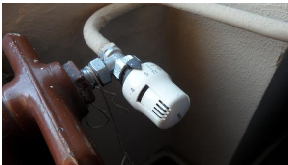
Figura 4.15 – Particolare valvola termostatica – radiatore in ghisa – scuola elementare
