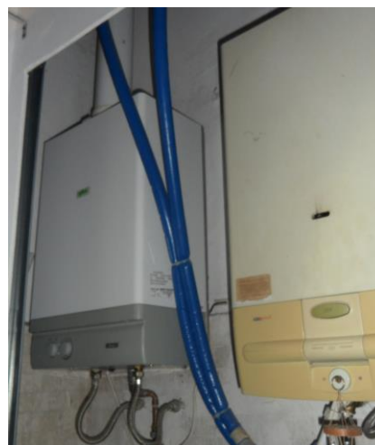
Figura 4.21 - Caldaia a metano di tipo tradizionale – Cucina
