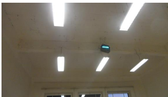
Figura 4.22 – Particolare dei corpi illuminanti ubicati nell'edificio- fluorescente 2X36W
