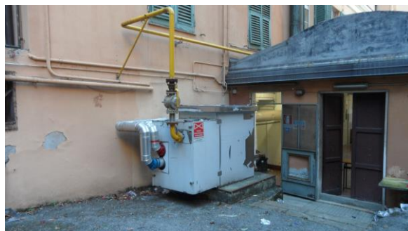
Figura 4.18 – Posizionamento generatore di calore
