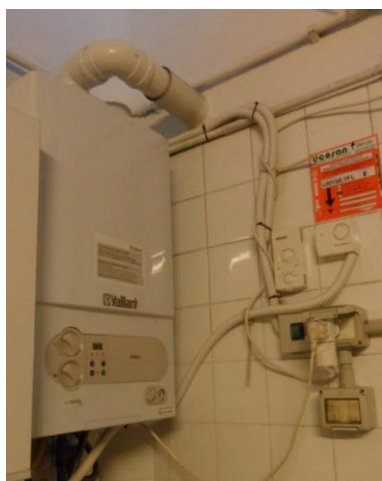
Figura 4.20 - Caldaia a metano di tipo tradizionale – Cucina
